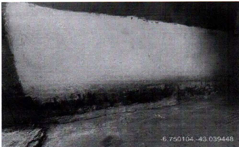
Figura 5: Vista de uma das paredes com infiltração
